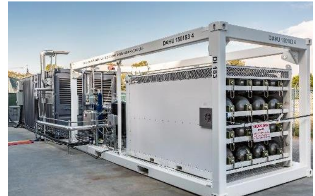
200 kW SOEC module in Los Angeles, USA
